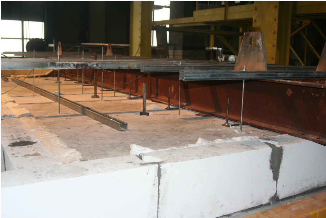
Photo V-1 : Vue de dessus du four, suspensions du conduit à l'aide de tiges filetées.
