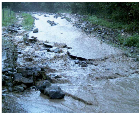
FIG. 1.2: Engravement progressif du lit et débordement sur les aménagements à partir de 10h
