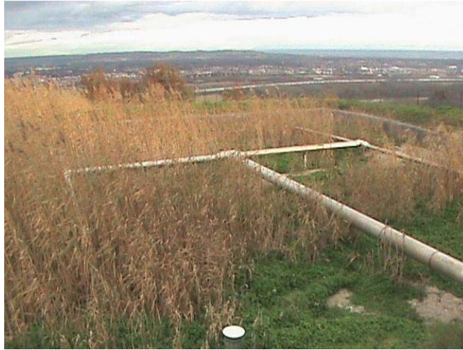
Figure 10 : Filtre planté de roseau à écoulement vertical avec le système d'alimentation (France)
