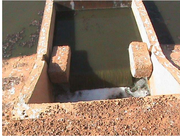
Figure 8: vue de la sortie du bassin anaérobie 2 de la lagune de Kossodo (Ouagadougou)
