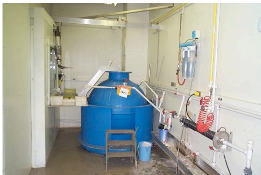
Figure 2.9.: Vue intérieure de l'installation au N.I.S.T.
