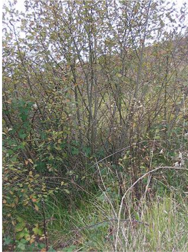
Figure 42 : Présence de végétation sur le remblai aval
