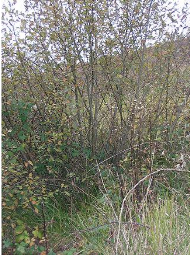
Présence de végétation sur le parement aval
