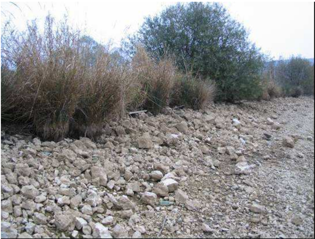
Figure 39 : Etat du rip-rap amont
