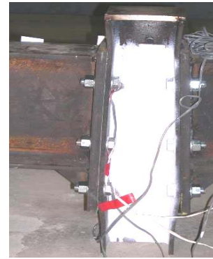
Photo 3 : Déformation des composants de l'assemblage FS3
