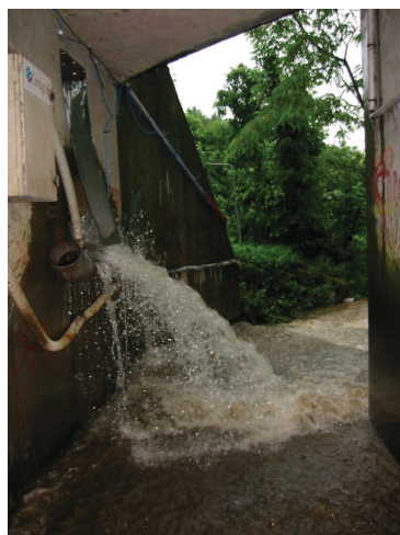
Figure A.0.3.: Picture of the storm water outlet under the Pont de la Barge in action (photo from équipe métrologie Cemagref Lyon).
