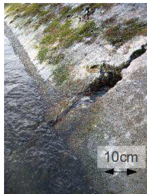
(a) Fuite récurrente, repérée à la jonction de deux dalles du contre-canal juste à l'amont du tronçon d'étude
