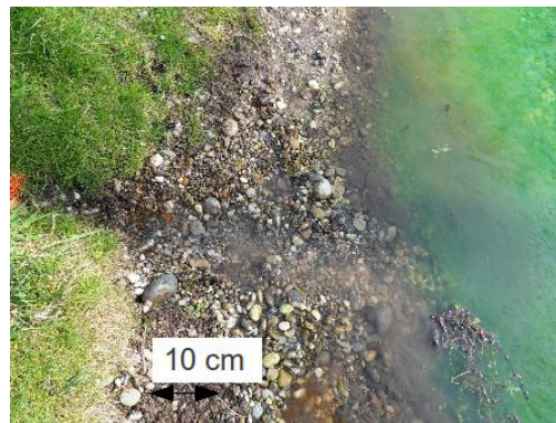
(b) Fuite localisée sur les cents premiers mètres amont du tronçon d'étude, présence majoritaire de matériaux grossiers.
