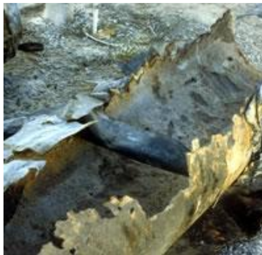
Figure 1.7 Tuyau d'égout détérioré suite à l'activité bactérienne
