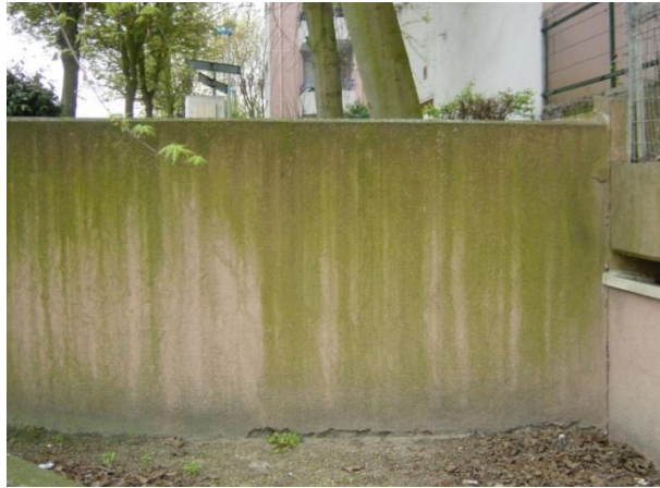
Figure 1.8 Mur verti suite à sa colonisation par des algues (Seine-et-Marne juin 2003)
