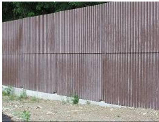
Figure 1.3 Efflorescences sur un mur antibruit en bétons de bois
