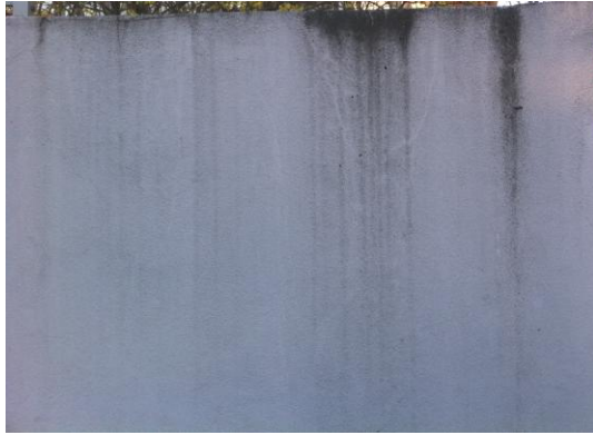
Figure 1.9 Mur noirci suite à sa colonisation par des champignons (Loire mars 2011)
