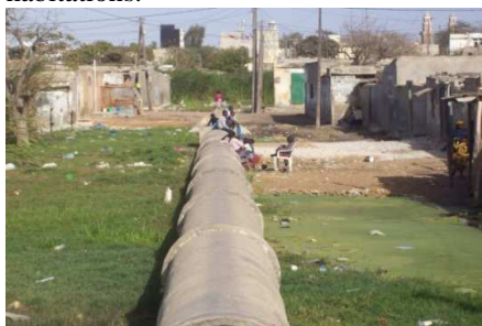
Photo 36 prise en 2009 Une vieille conduite d'eau de la Société des Eaux (SDE) qui surplombe la terre et qui était il y a, plusieurs années, en profondeur. Cette conduite, en période d'inondation, constitue le seul moyen de communication pour ces populations riveraines. On aperçoit des enfants
