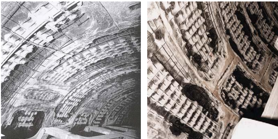
Figure 5.1. Photos des voussoirs du tunnel sous la Manche prises après l'incendie de 1996 [ULM 99].
