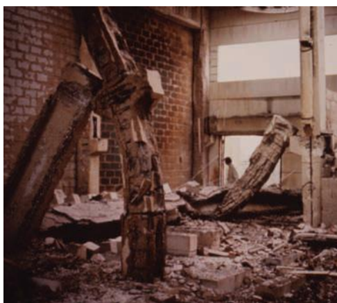
Figure 5.8. Endommagement des poteaux d'un hall d'essai [ANN 09]
