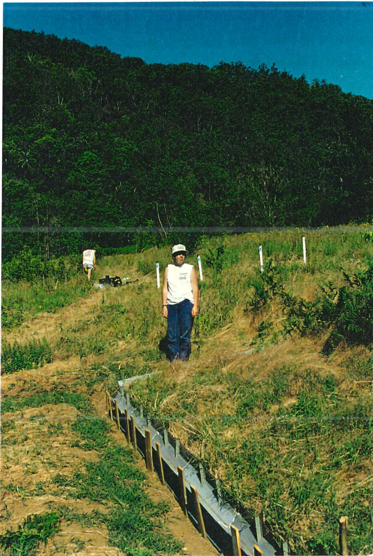
Figure i-3: Vue du dispositif de collecte des écoulements de surface et de subsurface installé sur la terrasse.
