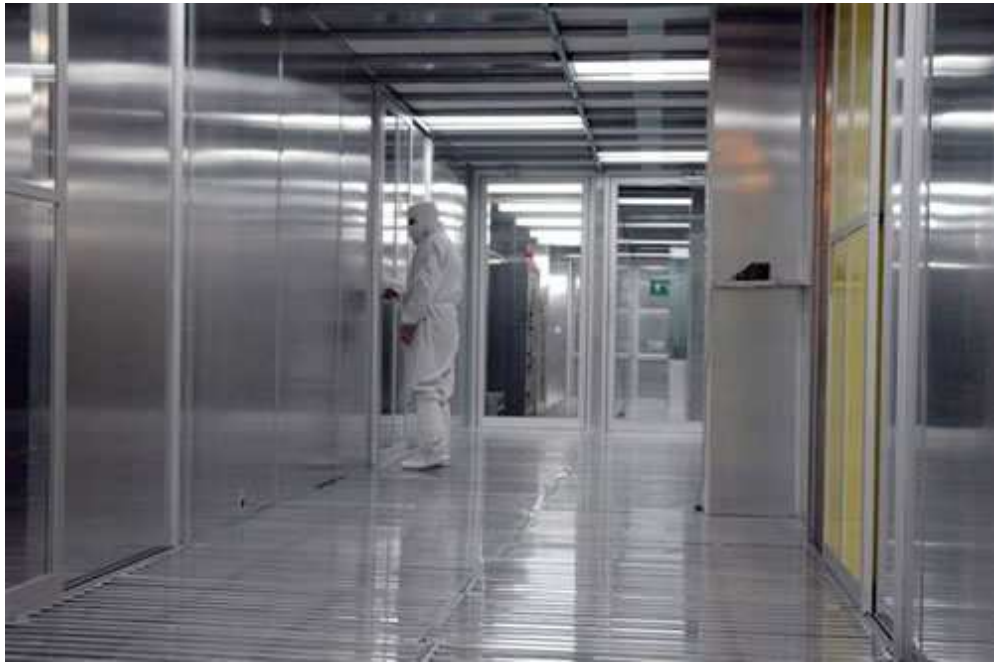
Image 2.2. Couloir central des salles blanches du LI-MEMS de l'INAOE. Source : http://www-elec.inaoep.mx/Inn/estructura/LIMEMS.php .
