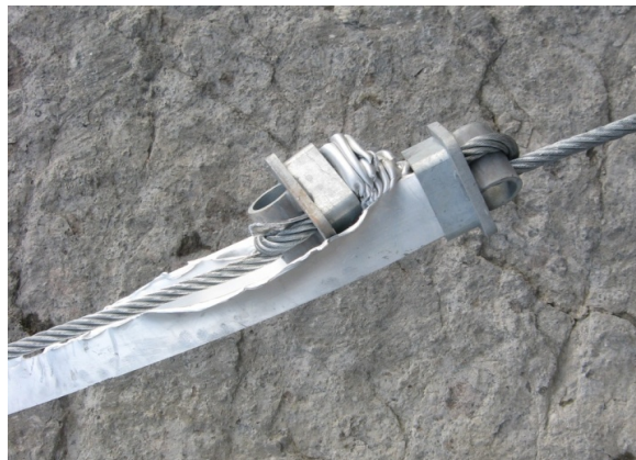
Figure IV. 25 : Déformation du dissipateur par flambage-déchirure
