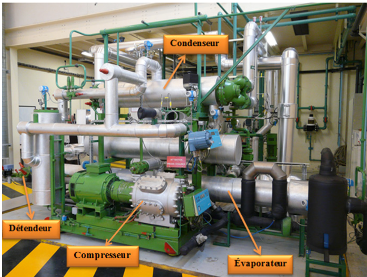
Figure 2. Photo de la machine frigorifique à pistons (EDF, site des Renardières)
