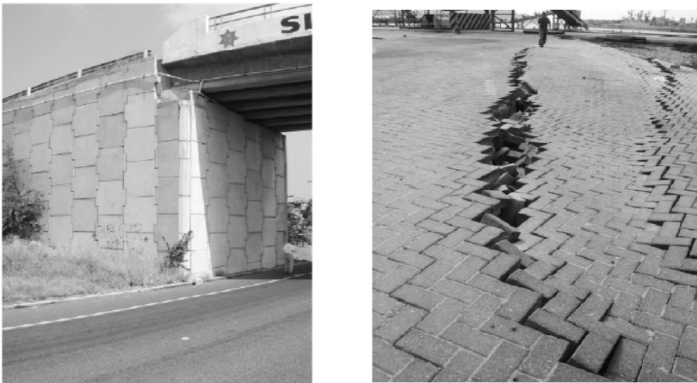
Figure 24. (gauche) Résistance d'un ouvrage terre-armée après un séisme de magnitude 7,5 à Tecoman au Mexique en 2003 – (droite) Etat d'un quai du port de Tecoman [BAS 09].
