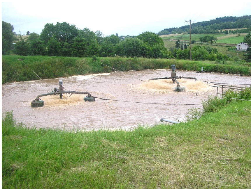
Photo 25 : Station d'épuration à Araules (Y. BENMALEK)
