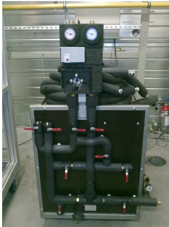
Figure 4-10 Photo de la panoplie hydraulique externe reçue pour la gestion du circuit de chauffage du SSCa
