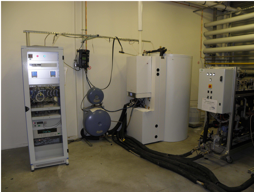
Figure 4-29 Photo du SSCb installé sur le banc d'essai thermique semi-virtuel
