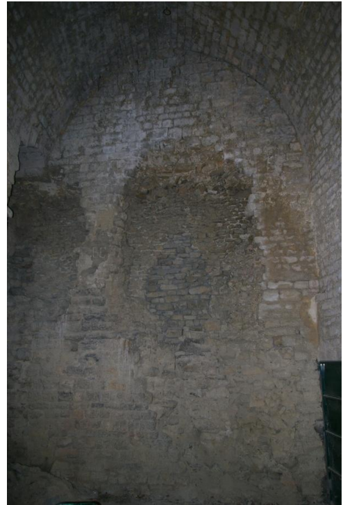
Fig. n° 74. A. Rez-de-cour de la tour de l'évêque, mur ouest. B. Premier niveau voûté en berceau brisé de la tour de l'évêque, mur est (cl. M. Varano).
