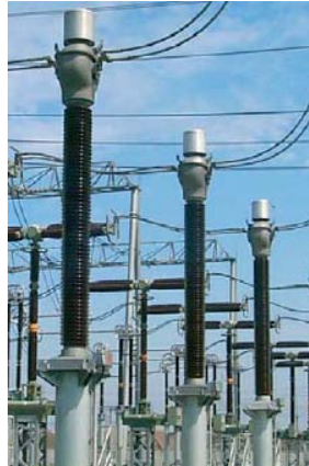
Fig. 3-24 : Alstom OSKF 765 current transformer
