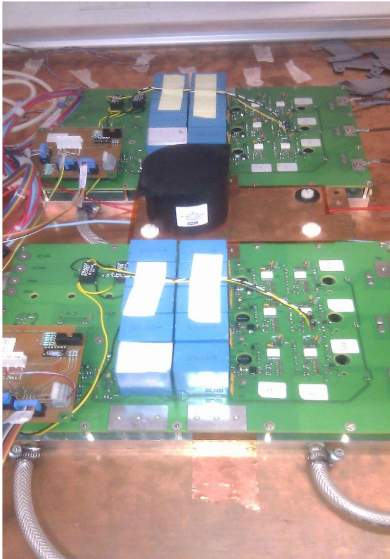
Figure IV.6.4-3 Onduleurs en parallèle posés sur le plan de masse
