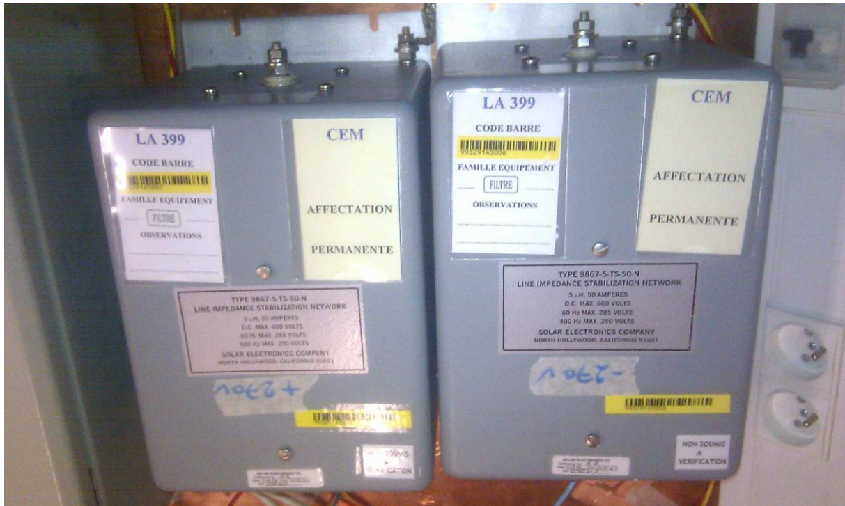
Figure IV.6.2-2 RSILs utilisés pour le circuit de puissance +/-270V
