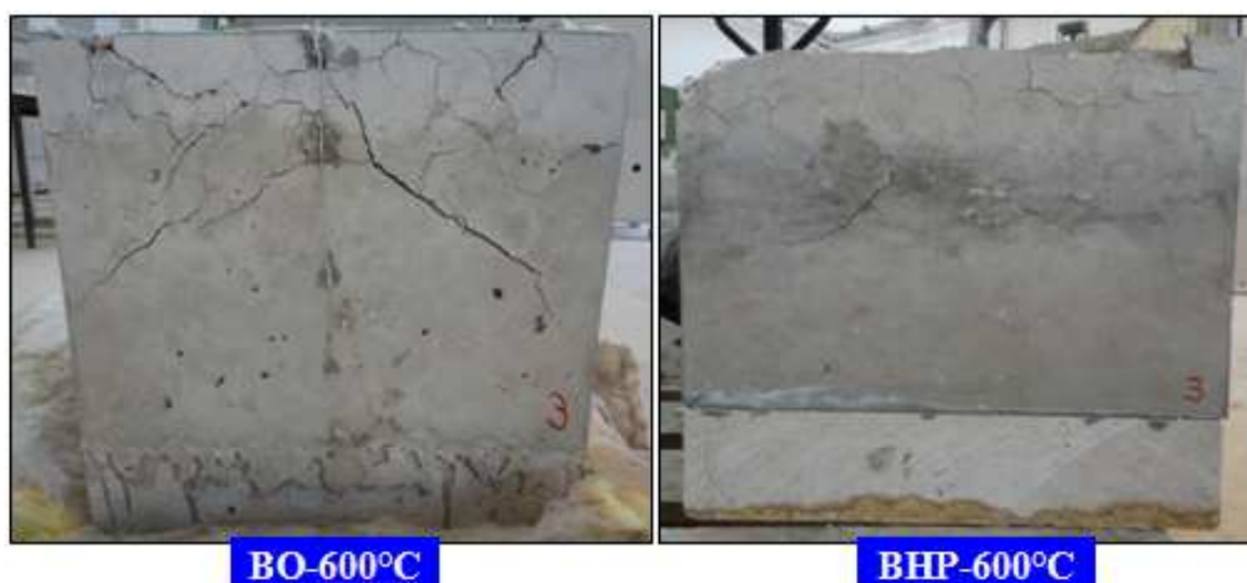
Figure 5.7 : Endommagement de la surface latérale des bicouches après le chauffage à 600°C.
