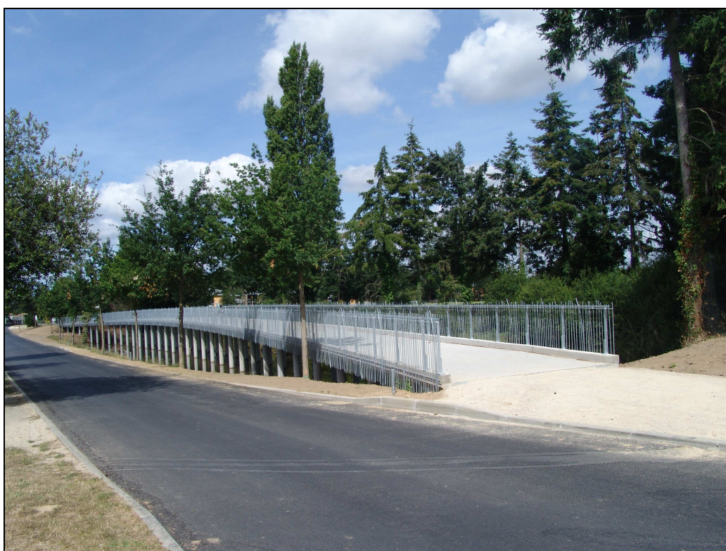
Photographie 30 : Construction sur pilotis d'un pont d'accès au village résidentiel de tourisme le "Hameau de la Chaize" (Crédit photographique : Janique Valy, le 06/07/2010)
