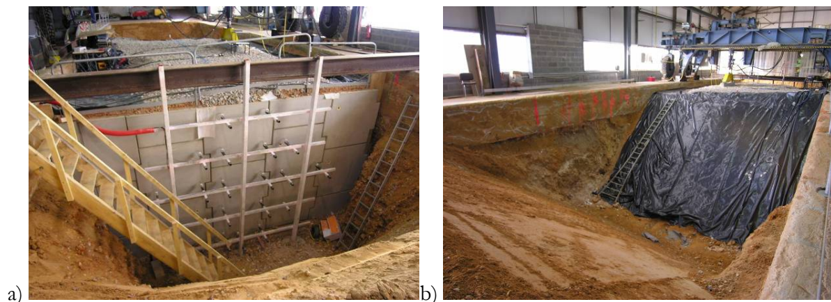
Figure 2-1 - Insertion du plot expérimental dans la fosse d'essais : a) vue côté parement, b) vue côté remblai technique.
