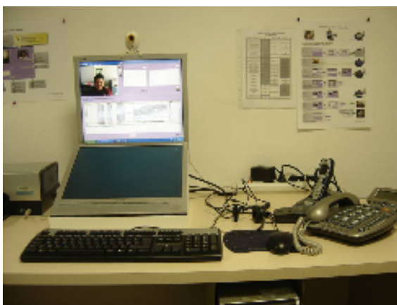
Figure 33- Poste central du système vidéoconférence (station soignant)
