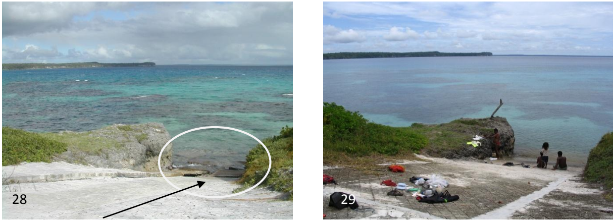
Photos 28 et 29 : Etat de la rampe de mise à l'eau au niveau de la ZT, prises de vue en avril 2005 (28) et en février 2009 (29).
