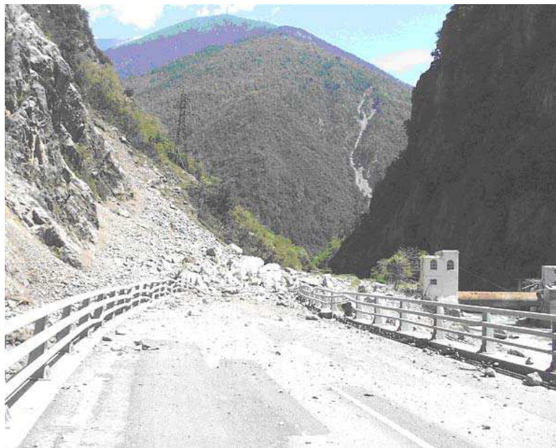
Figure 57 : Éboulement du 20 mai 2000 – Photo A. Calvino (LRPC Nice)
