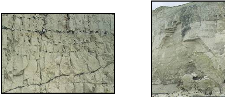
Figure 2.5 : Photo d'une falaise de craie normande : mise en évidence des fissures
