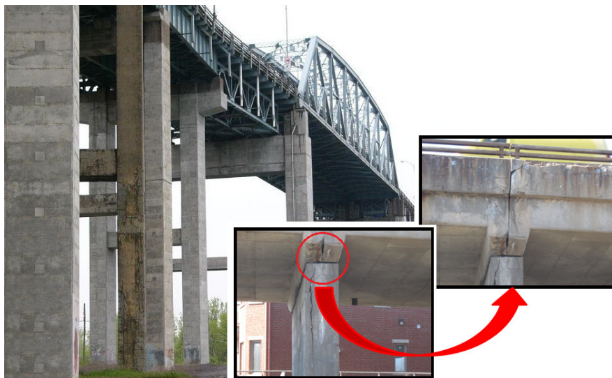
FIGURE 1.1 – Pont Honoré-Mercier à Montréal et détail des fissures sur l'une des piles.
