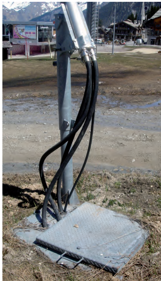
Photo 3.15 : Regard d'alimentation en eau et air d'un enneigeur bi-fluide (cliché : P. Paccard, le 07/05/2009, Courchevel, Savoie)
