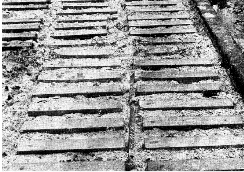
Figure 5.5-Condition de poutrelles après dix années d'exposition à un sol riche en sulfates (10% \text{Na}_2\text{SO}_4 ) essais de longue durée de la PCA, 1952. [130]
