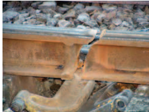
(b) Rupture simple sur soudure
