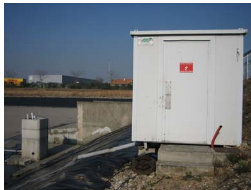
Figure 20 : Accès facilité aux appareils de mesures dans un local technique proche du point de mesure sur le site de Chassieu à Lyon (INSA de Lyon – site de l'OTHU)
