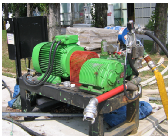
FIG. III.19 – Vue de la pompe de pression utilisée
