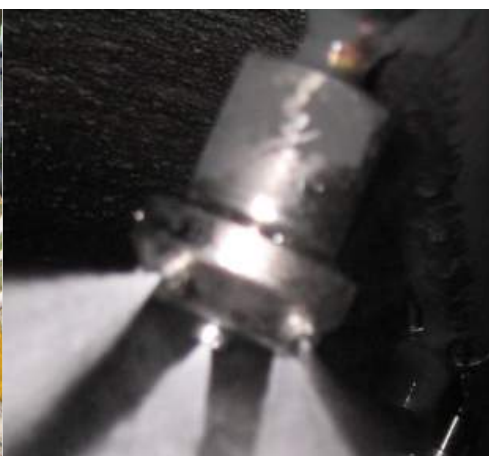
FIG. III.20 – Vue d'une des buses d'aspersion en action
