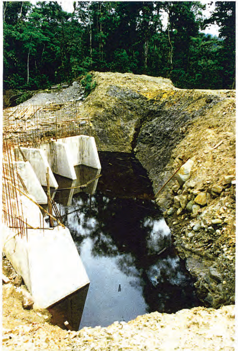
FIG. 86 – Suintement d'huile dans le Tertiaire au niveau des fondations d'un pont sur le Rio Kerosene, Route Palos Blancos-Yucumo.
