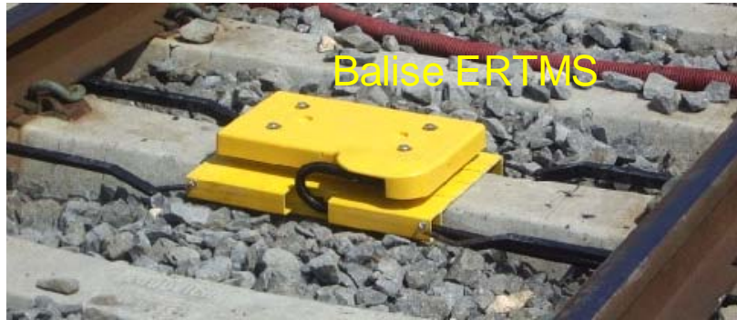
Fig. 1. 3. Balise ERTMS fixée sur la voie (www.mermecgroup.com)
