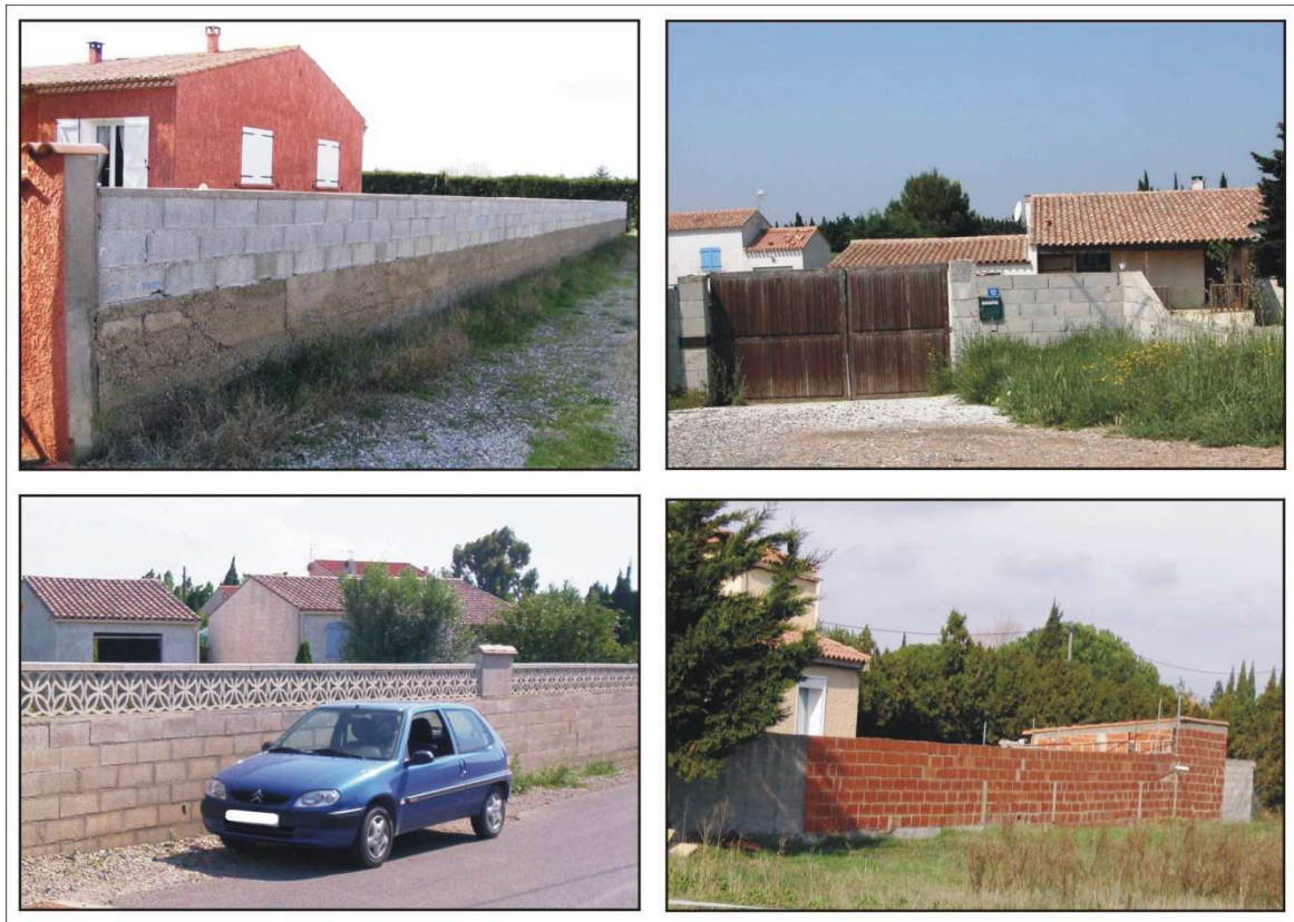
Photographie 7.2 : Exemple de clôture ne respectant pas la réglementation, Cuxac-d'Aude (Clichés : S. Defossez, 2004)
