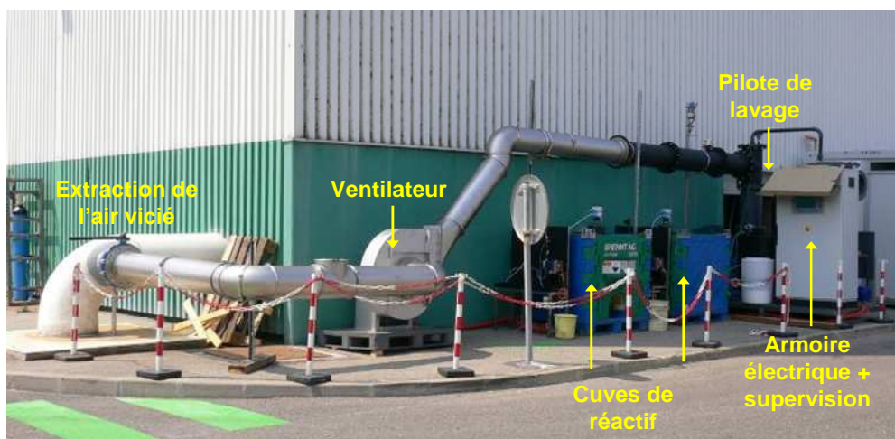
Figure 22. Photographie du réseau d'aspiration de l'air vicié dans la canalisation d'extraction de la station.
