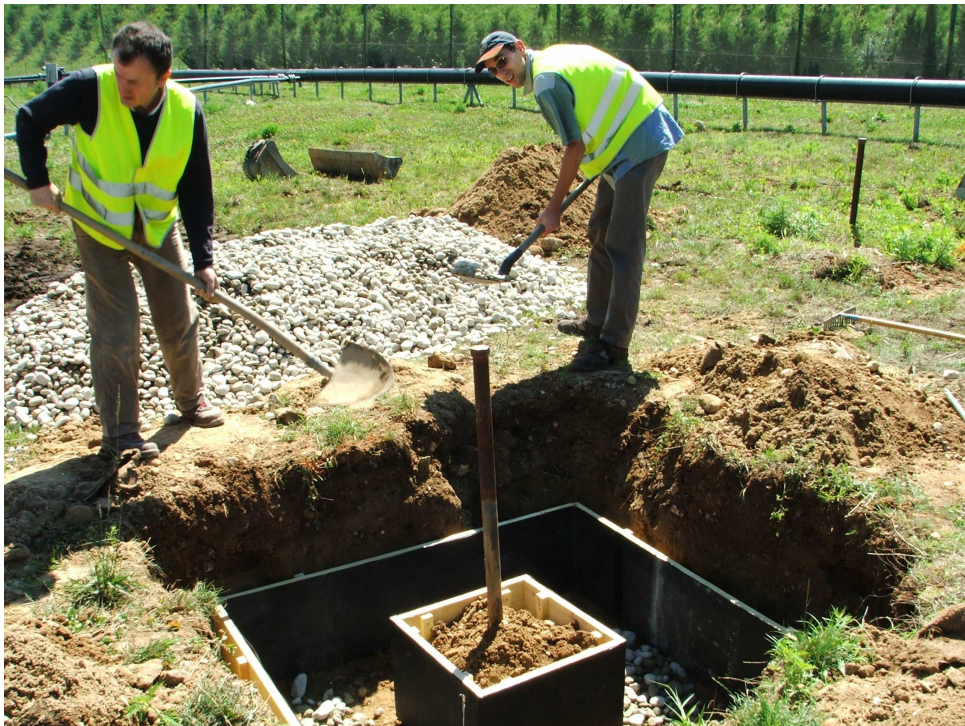
Figure III-34 : photographie de la chambre d'injection en cours de remplissage par du gravier. On distingue au centre le tube N3 utilisé pour les mesures à la sonde à neutrons et gamma.
