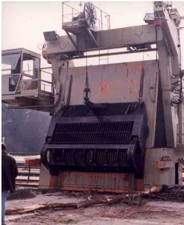
Photographie 18 : Dégrilleur du barrage de Saint-Egrève (Isère, France, B. Moulin).
