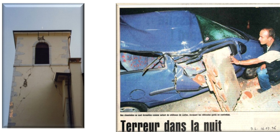
Figure 1. 9 : Aperçu des dégâts matériels occasionnés par le séisme d'Annecy (pas de victimes).
