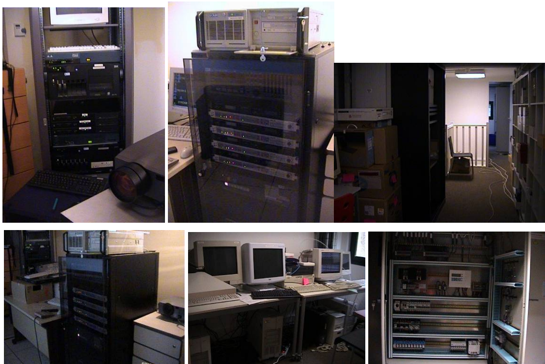
Figure 27 : Locaux techniques du K1 (décembre 2000)
