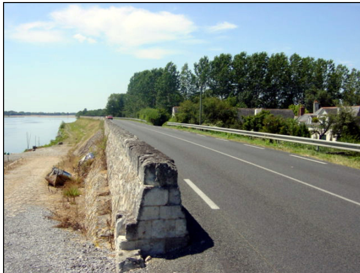
Photographie 85 : La levée à La Bohalle : côté Loire le renforcement de l'ouvrage est réalisé, côté val les travaux sont suspendus en attendant la décision du tribunal administratif (réal. H. Davodeau, juillet 2003).
