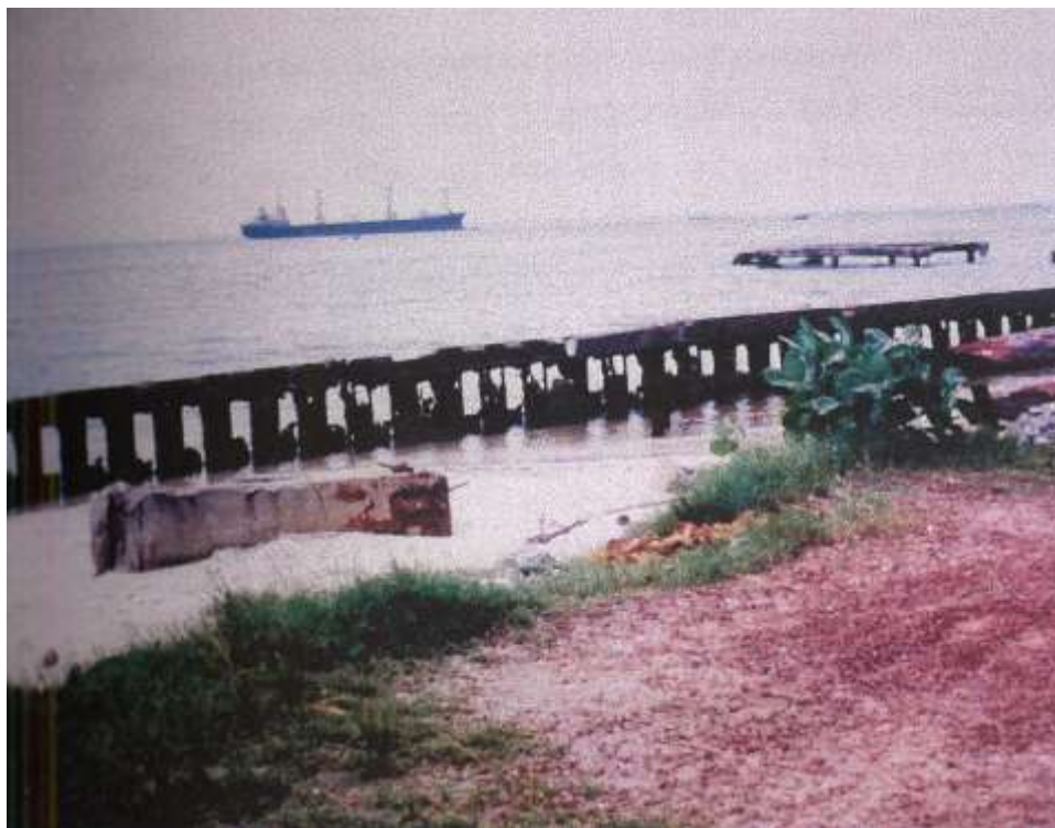
Photo 17 : Dégradation des palplanches le long du bord de mer de Port-Gentil (Mombe, 2000)
