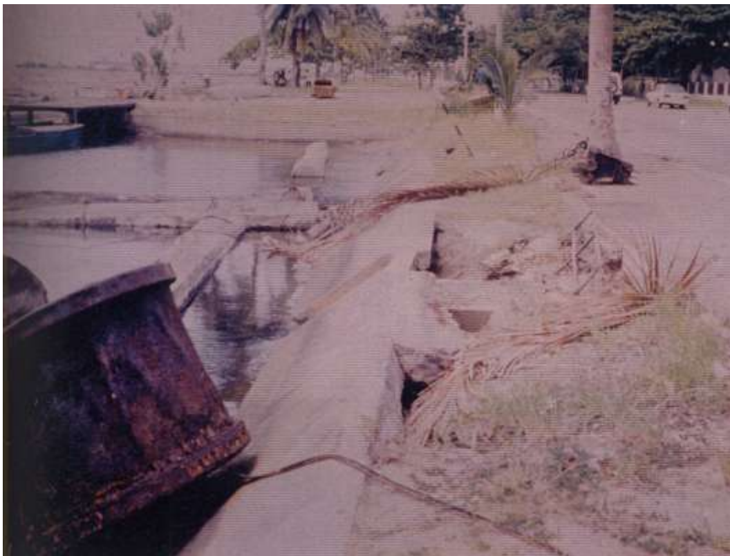
Photo 19 : Perré en béton détruit par les vagues sur le front de mer de Port-Gentil (Mombé, 2000)
