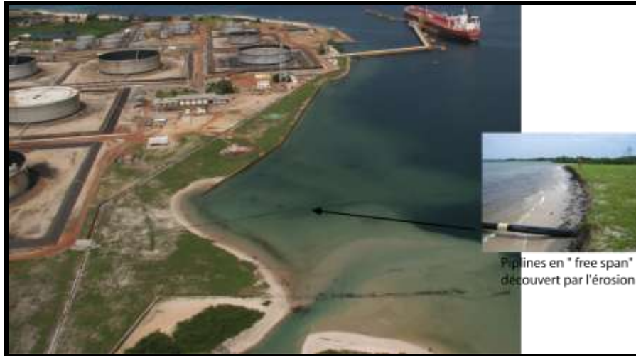
Figure 111 : Situation des pipelines au niveau de la crique d'éléphant (Total Gabon, 2007)
