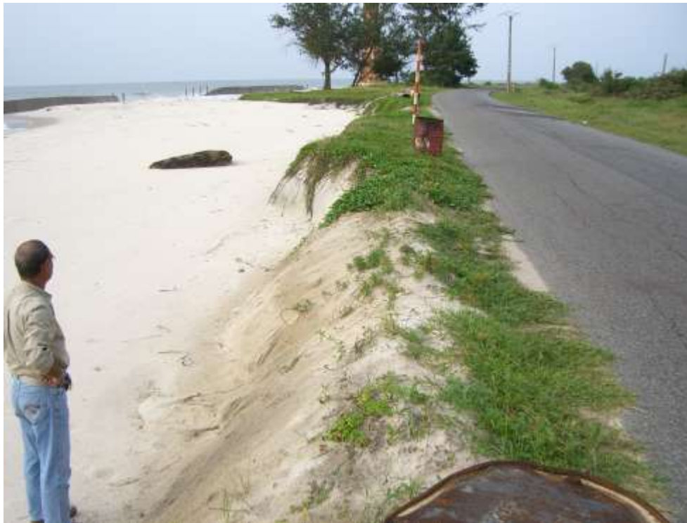
Photo 14 : Destruction de la nationale L123 en Mai 2007 (Menie, 2007)
