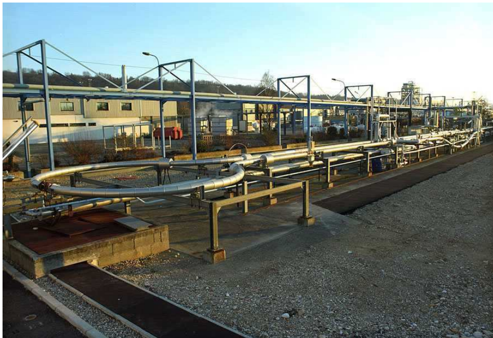
Figure 38 : Photo de l'installation de la boucle Lyre.
