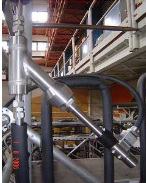
Figure 36 : Photo de la sonde FBRM sur la boucle Archimède.
