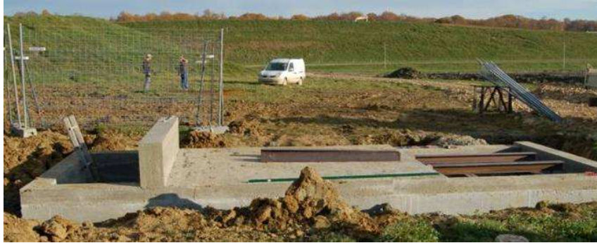
FIG. 90 : Fosse en béton armé avec emplacement de la plaque (à droite) d'après Camp (2008).
