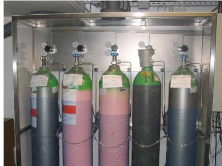
Figure 2 Stockage des bouteilles de gaz dans un châssis spécial
