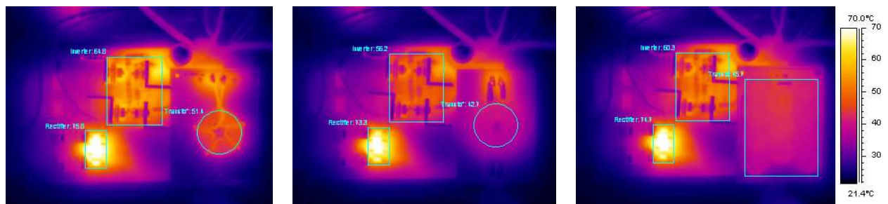
Figure I-20 : Images thermiques des trois transformateurs en régime permanent et en pleine charge – Transformateur classique (gauche) ; Transformateur SSWT (centre) ; 11 transformateurs 1:1 (droite)
