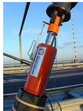
FIGURE 1.2 – Une suspension magnéto rhéologique en place sur un hauban du pont Franjo Tudjman à Dubrovnik
