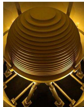
FIGURE 1.1 – L'étouffeur dynamique accordé de la tour de Taipei 101
