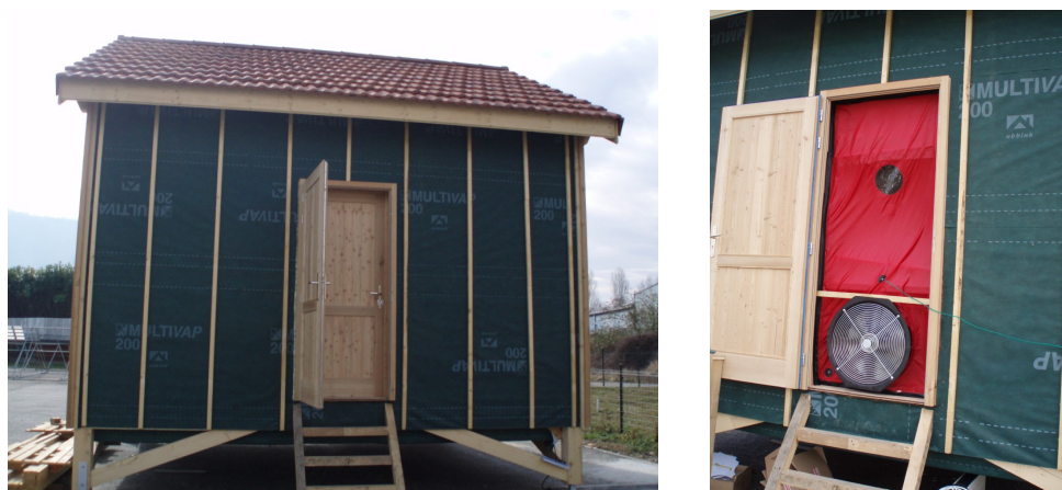
Figure 2 : Fausse porte mise en place au niveau de la double porte d'entrée
